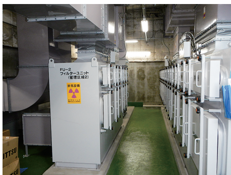
RI 排気設備
