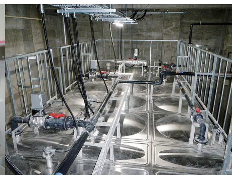
RI 排水設備
