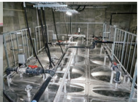
RI 排水設備
