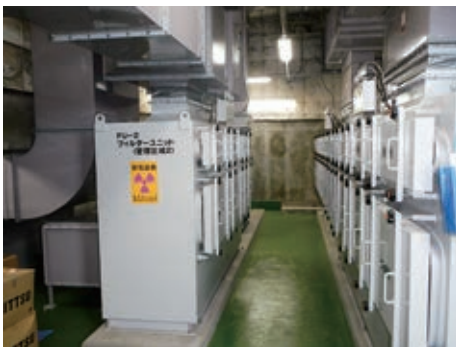
RI 排気設備
