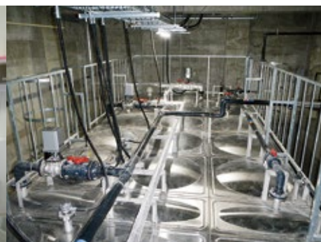
RI 排水設備
