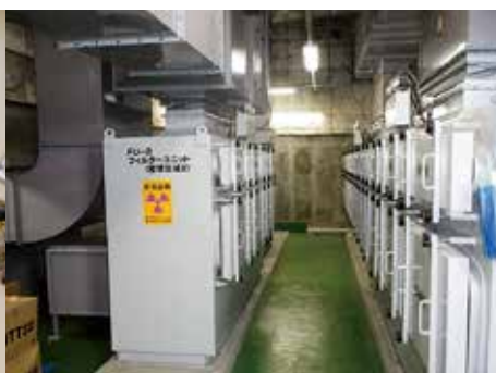
RI 排気設備
