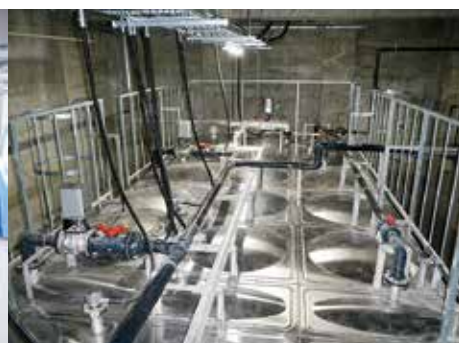
RI 排水設備
