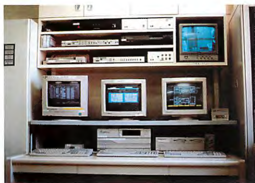
図1. アイソトープセンターの総合監視システム
